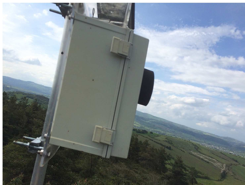
Figure 14 : Cliché du positionnement d'une BCBox sur mât de mesure
